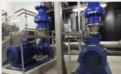
Wasserwerk, Wertheim, Germany Die dreistufige Wasseraufbereitung des Wassers aus den Tiefbrunnen erfordert fein abgestufte Prozess-Schritte. Der Einsatz von VLT® AQUA Drives ermöglicht die erforderliche Prozessgüte.
